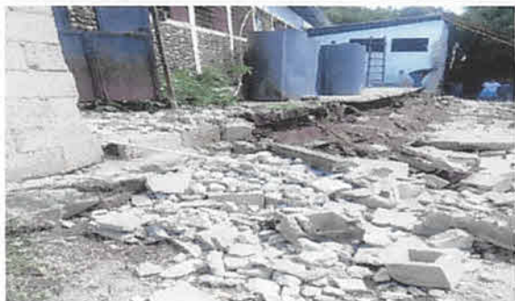
Foto1: Área del Muro Perimetral derribada.
